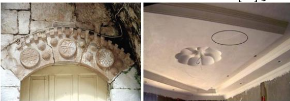
شكل (١٠) يميناً : ظهور بعض الشقوق في الأعمال الزخرفية الجبسية يساراً: يوضح الانفصال بين الأحجار في النقش الحجري المثبت على الجدران. المصدر: (الباحث)
